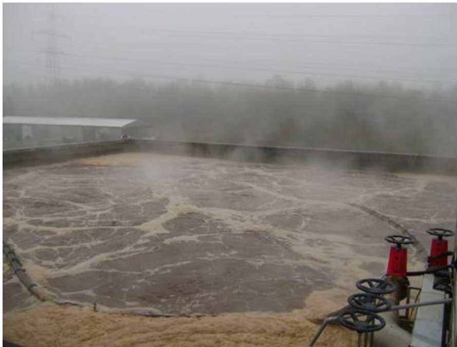
Slika 20. Uređaj za biološko pročišćavanje otpadnih voda (GRLIĆ, 2019.)
