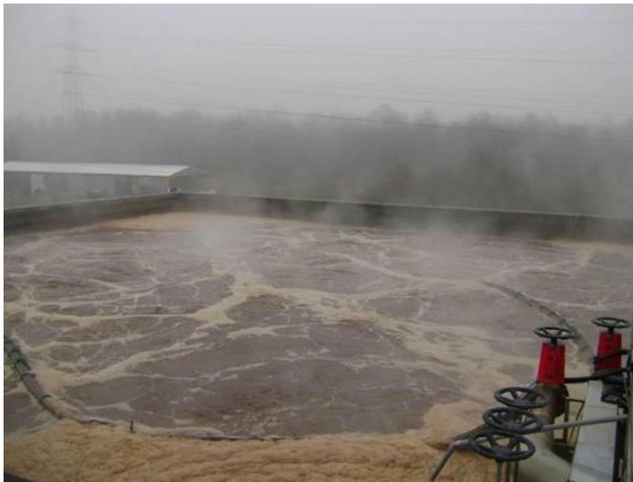
Slika 20. Uređaj za biološko pročišćavanje otpadnih voda (GRLIĆ, 2019.)
