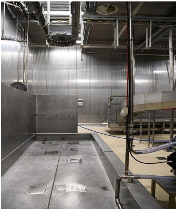
Slika 11. Bazen za iskrvarenje (PIK Vrbovec plus d.o.o.)
