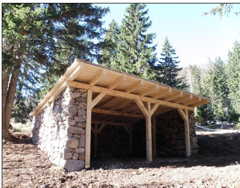
Slika 21. Nadstrešnica za ovce
